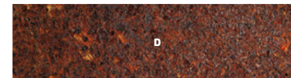
Superficie de acero cuya calamina ha desaparecido por acción de la oxidación y en la que se ven numerosas picadas
