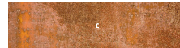
Superficie donde la calamina ha desaparecido por la acción de la oxidación o que se puede eliminar raspando, pero con leves picadas visibles
